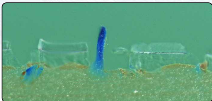
Claro defeito de revestimento
