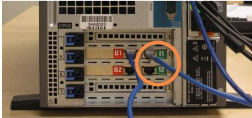
Figura 16-3: Portas de instrumento da estação de trabalho
